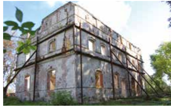
Das Renaissance-Herrenhaus Üselitz verfiel ab den 1970er Jahren. Die Ruine wurde durch die neuen Besitzer gesichert.
