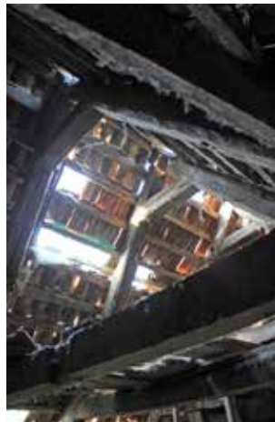
Abb. 8, 9: Akute Schäden die sofortige Wintersicherung erfordern, 2015, Gerd Albrecht.
