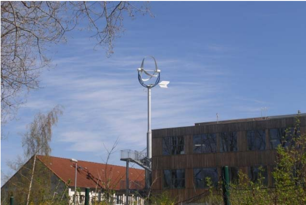
Abb. 6-3: Kleine WEA von Dela Rotor an einer Plusenergieschule in Rostock 48
