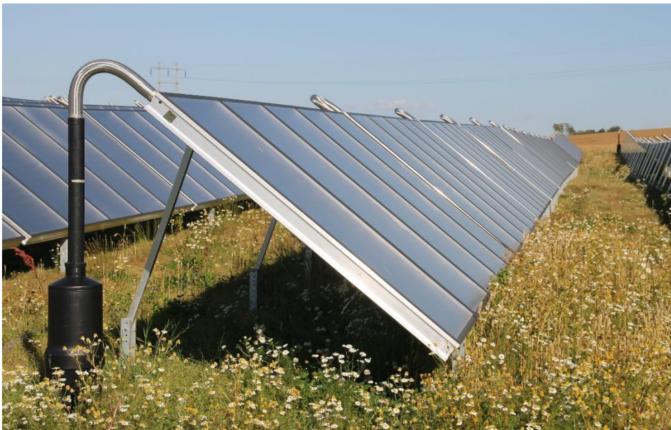
Abbildung 5: Flachkollektoranlage in Freilandaufstellung (Foto: Hamburg Institut)
